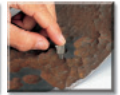
外部腐食がある試験体の測定
